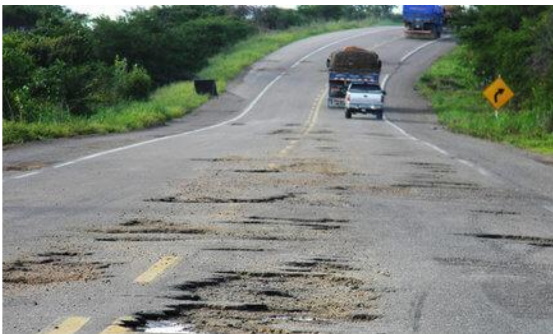
Figura 5 – Rodovias Asfaltas sem Manutenção
